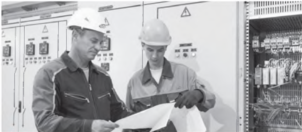
Для обеспечения бесперебойной работы завода потребовалось внедрить сложнейшие временные схемы электроснабжения (на фото слева Алексей Зеленко)
