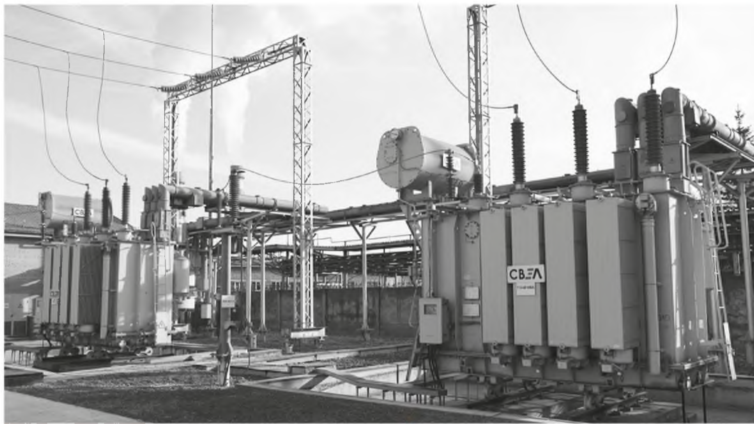
Силовые трансформаторы и реакторы на подстанции «Искитимская»
