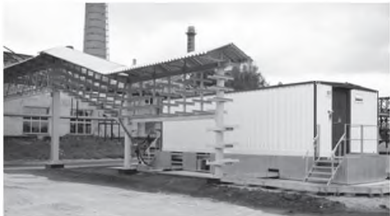
Кабельная эстакада и трансформаторные подстанции напряжением 6 кВ
